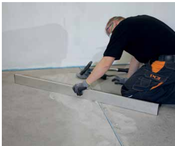
Fig. 3 – Tilladt ifølge normen, men ikke tilstrækkeligt jævnt til lægning af store formater; i det aktuelle tilfælde er en udjævning nødvendig.
