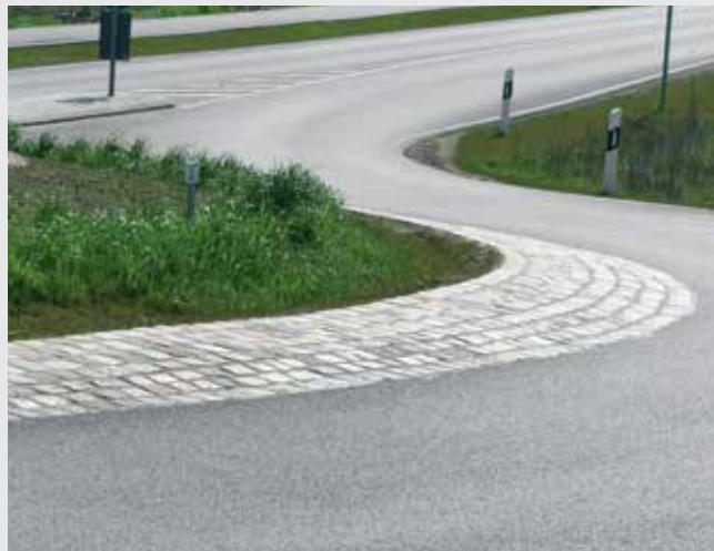
Kraftigt belastede områder som rundkørsler og busbaner vil ofte kun kunne holde i en bundet konstruktion.
